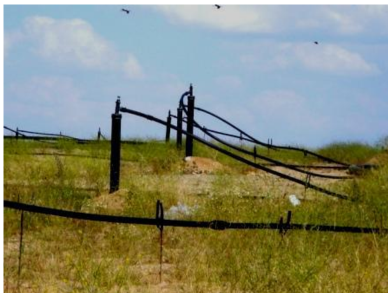
Figura 14 - Sistema de extração de biogás (Encbioenergy 2013).
